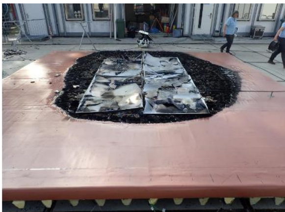
Figur 20. Översikt över bränt tak, PIR.
